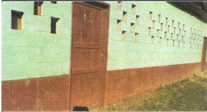
Foto 1: Se necesita sustitucion de puertas de madera deterioradas por puertas de metal
