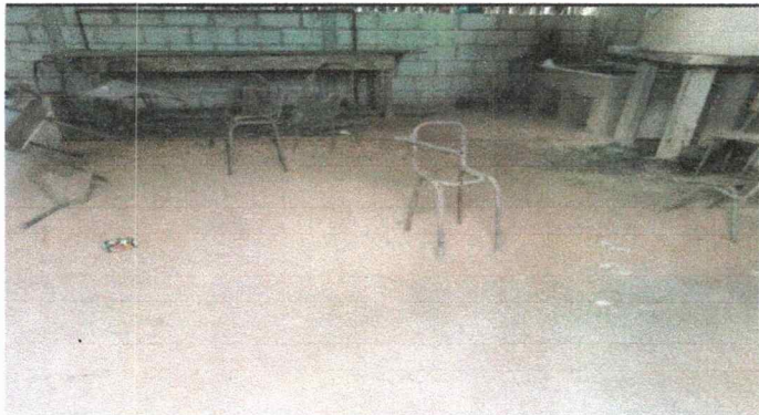
Foto 3: Se observa la necesidad de colocar piso de concreto en el area de la cocina, ya que al elaborar los alimentos se levanta mucho polvo y se humedece al suelo.
