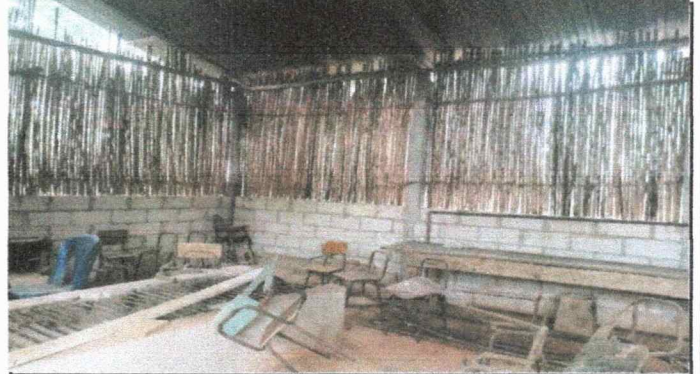
Foto 2: Se observa que es necesario cambiar las barritas de madera de las ventanas por metal para mayor seguridad del area de la cocina.
